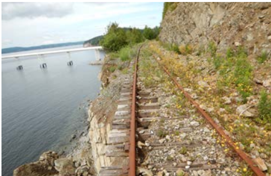
Le décrochement à Port-Daniel-Gascons a eu pour effet de déchausser 15 mètres de voie ferrée.
